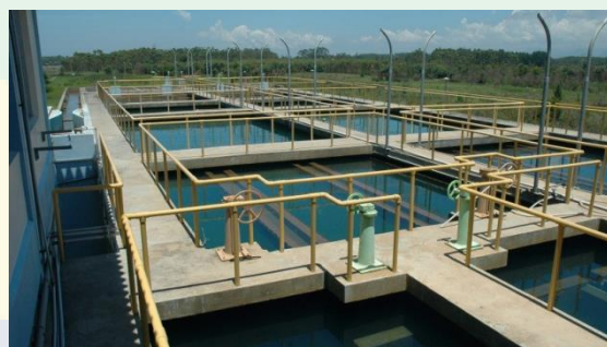
Figura 3. Estação de tratamento de água.
